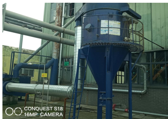
2 号（甲类）生产车间布袋除尘器
