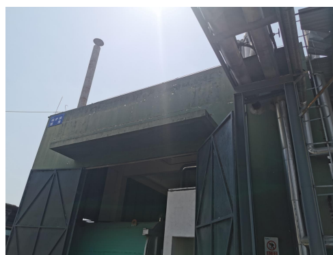
导热油锅炉排气筒 DA003
