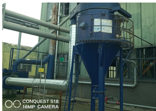
2 号（甲类）生产车间布袋除尘器
