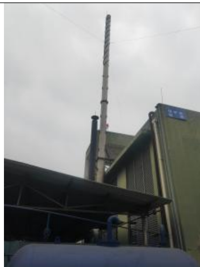
焚烧炉废气排放口 DA004
